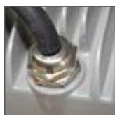
wyprowadzony przewód zasilający 3x1,0mm 2
