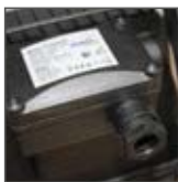
puszka łączeniowa z dławikiem kablowym IP44
