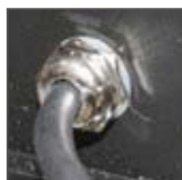
wyprowadzony przewód zasilający 3x1mm 2
